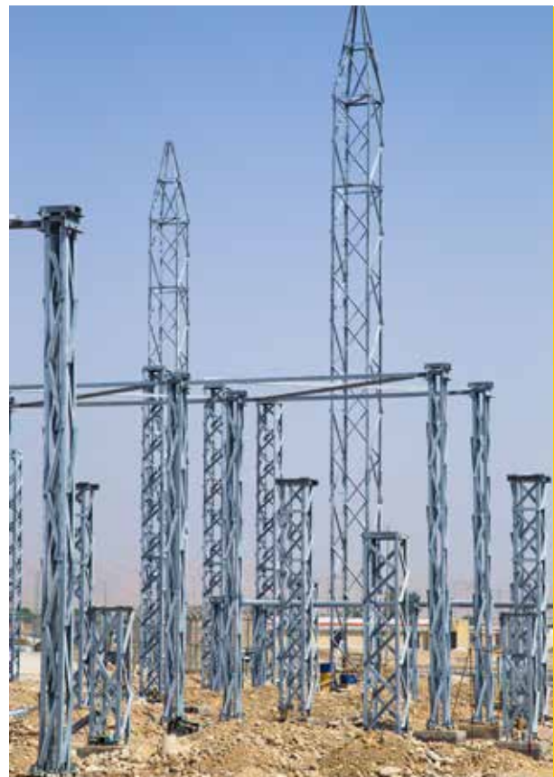
• پروژه پست برق ۲۳۰ کیلوولت پالایشگاه بیدبلند - خوزستان
